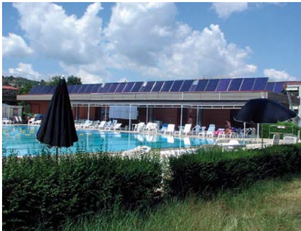
Pannelli solari termici sulla piscina comunale di Cosenza
