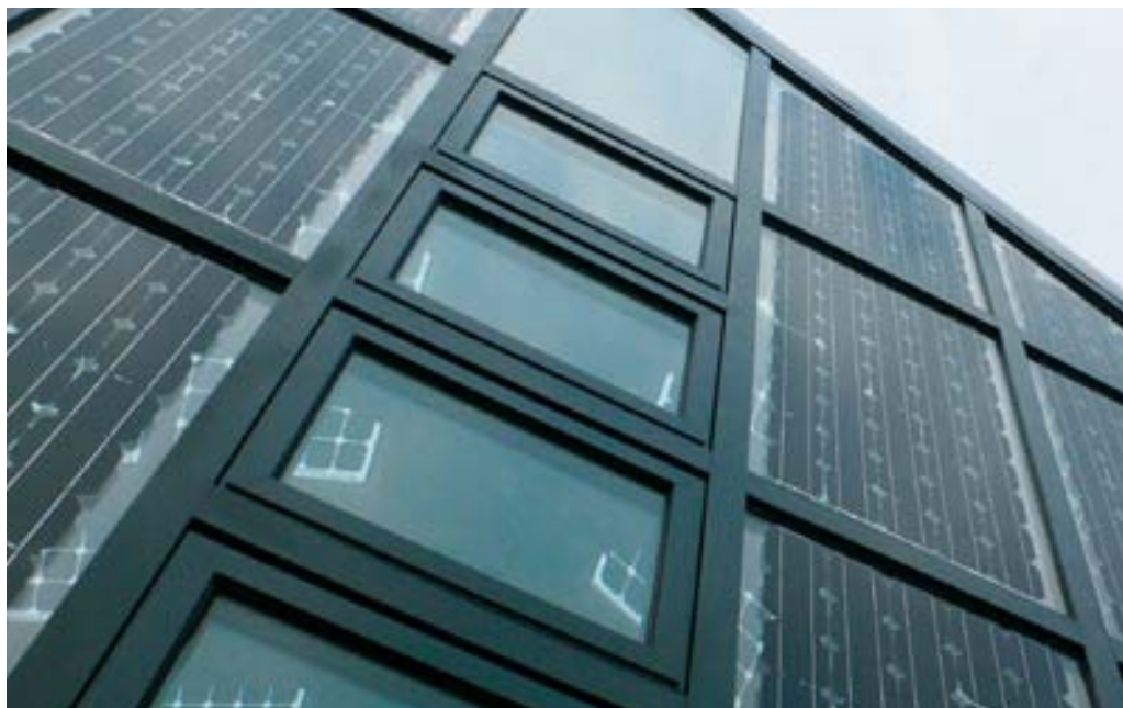
Impianto fotovoltaico a parete verticale su serra fotovoltaica a Torino
