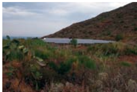
Impianto fotovoltaico off-grid a Ginostra nel Comune di Lipari (ME)
