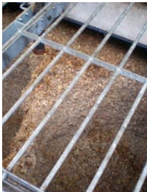
Vasca di raccoglimento del cippato del piccolo impianto a biomassa a Caldaro sulla Strada del Vino (BZ)
