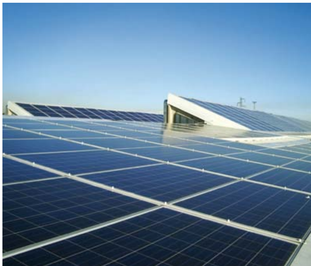
Copertura fotovoltaica su tetto aziendale a Buccinasco (MI)
