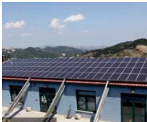
Impianto fotovoltaico sulla palestra comunale di Peglio (PU)
