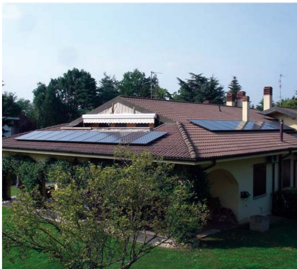
Impianto solare termico su abitazione privata
