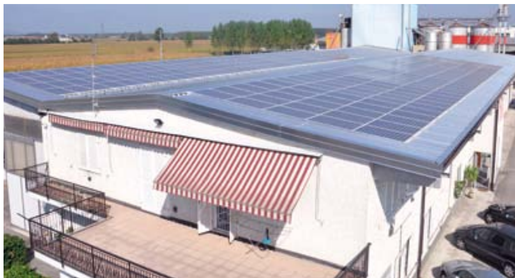
Impianto fotovoltaico integrato nel Comune di Torre San Giorgio (CN)
