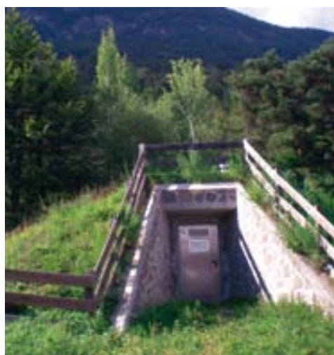
Impianto mini idroelettrico su acquedotto nel Comune di Appiano sulla Strada del Vino (BZ)
