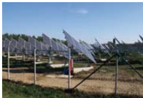
Impianto fotovoltaico ad inseguimento su ex cava di inerti nel Comune di Saluzzo (CN)
