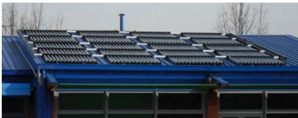
Pannelli solari termici sul tetto dell'asilo del Comune di San Sebastiano Po (TO)
