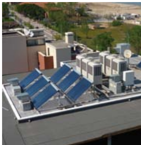
Solare termico sul tetto del Noha Club a Riccione (RN)
