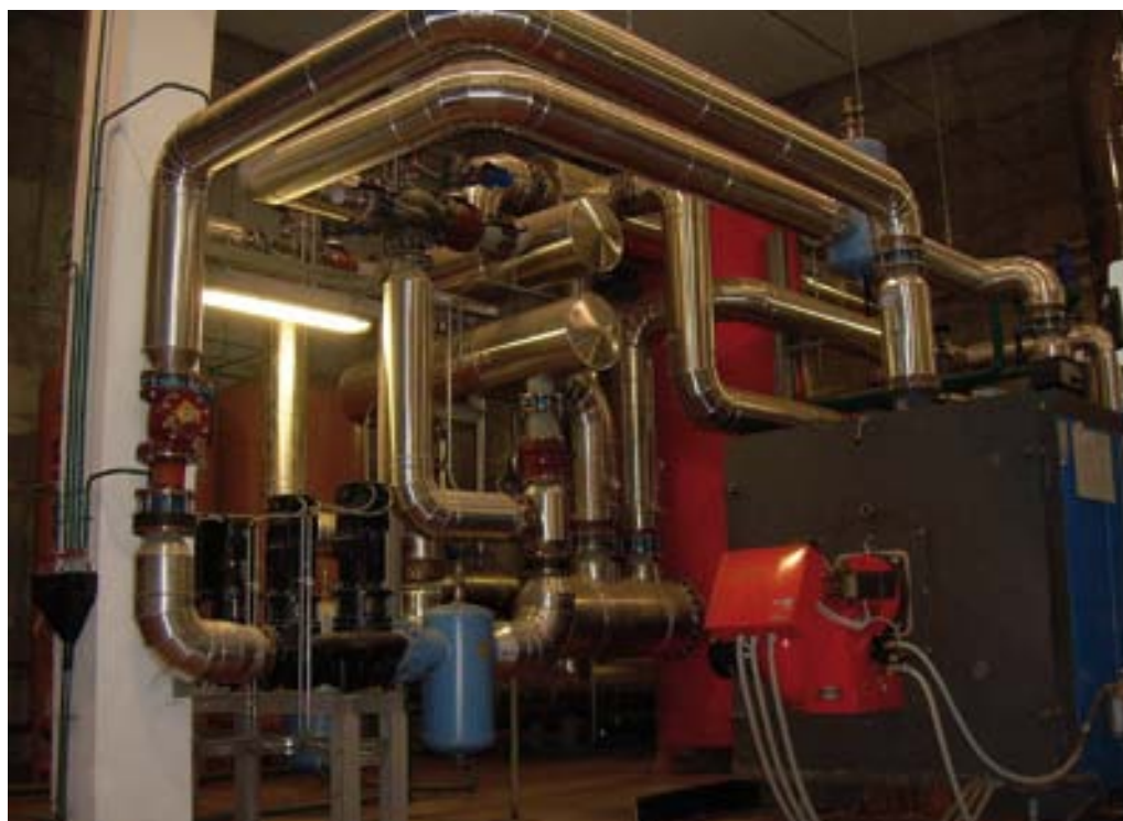
Interno della centrale a biomassa a Morgex (AO)
