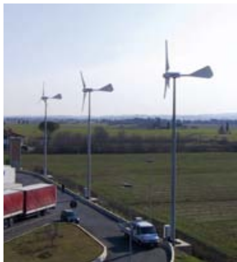
Impianto mini eolico da 60 kW alla stazione di servizio del Comune di Grecciano (LI)
